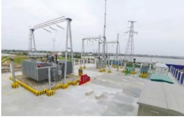
常德项目升压站
