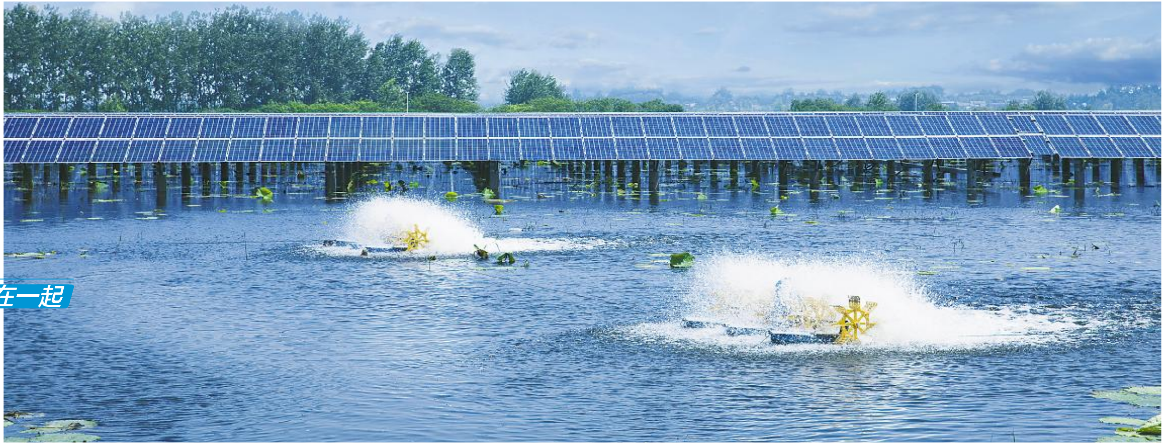
通威扬中“渔光一体”产业园
