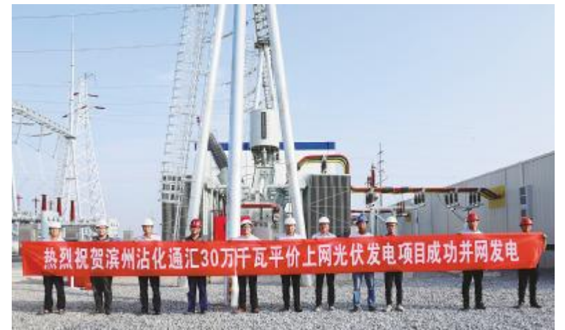
通威滨州沾化通汇“渔光一体”项目成功并网
