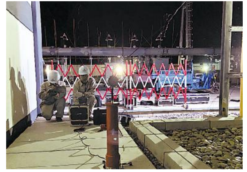
升压站夜间预试
